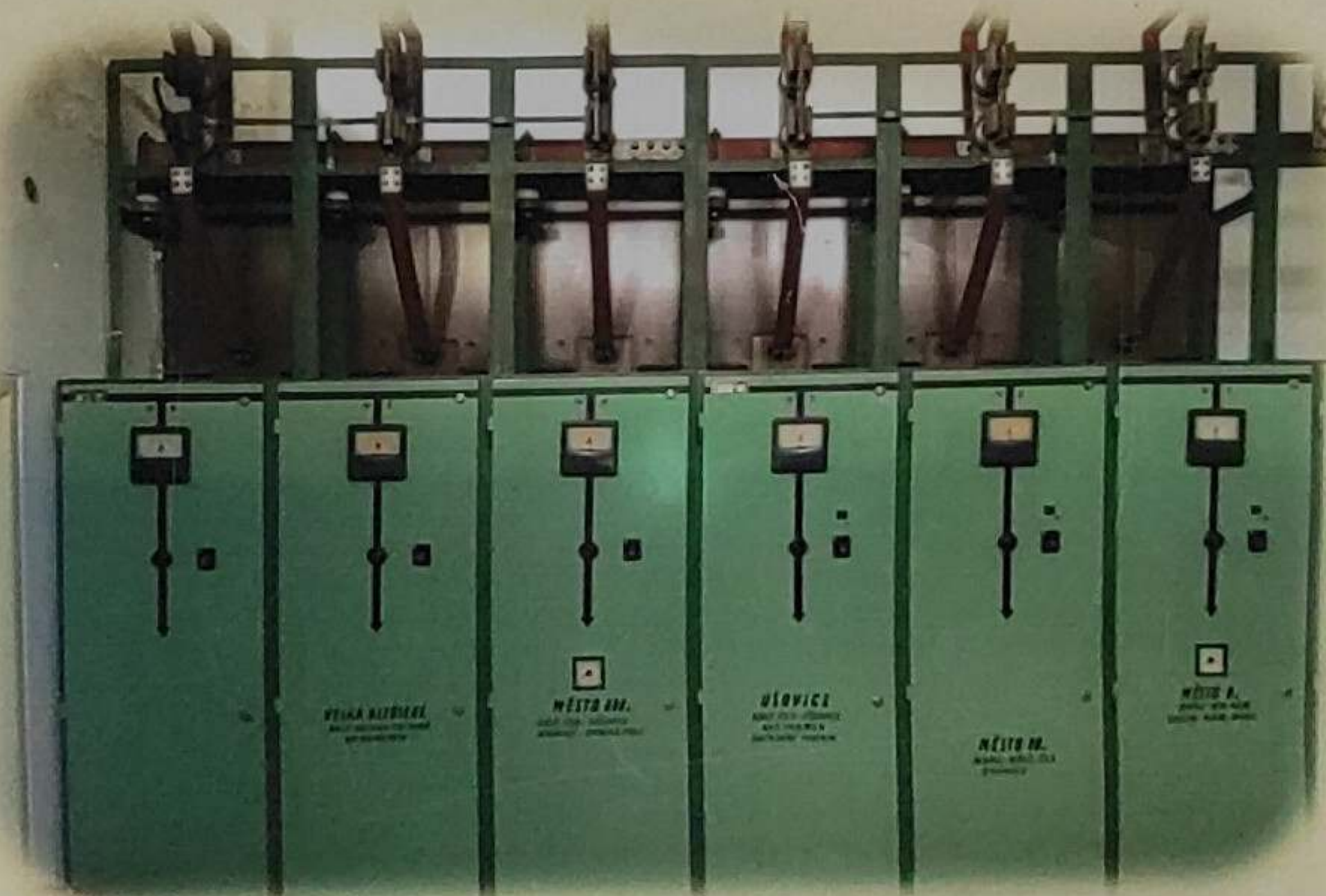
Vypínače napájecích úseků v současné měšírně.
